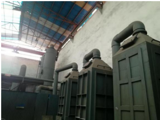
8级尾气净化设施
