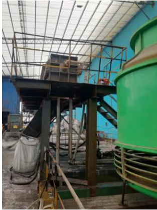
废水处理设施
